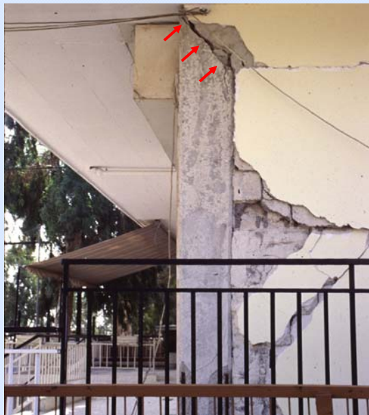
Διαγώνια ρηγμάτωση εξωτερικού κόμβου
