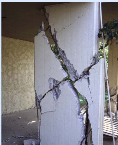
Διατμητική αστοχία τοιχώματος με μεγάλες παραμορφώσεις
