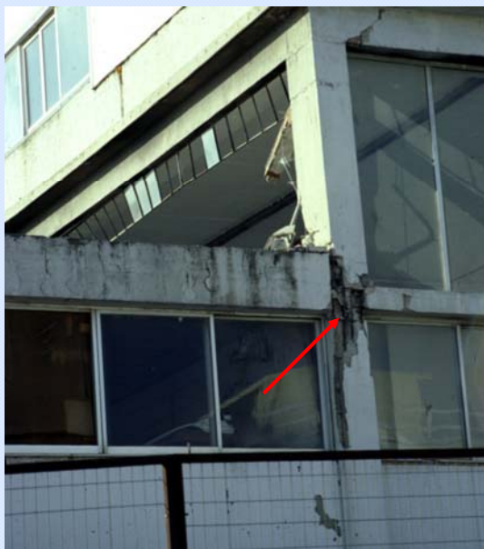
Εμβολισμός υποστυλώματος από την πλάκα γειτονικού κτιρίου
