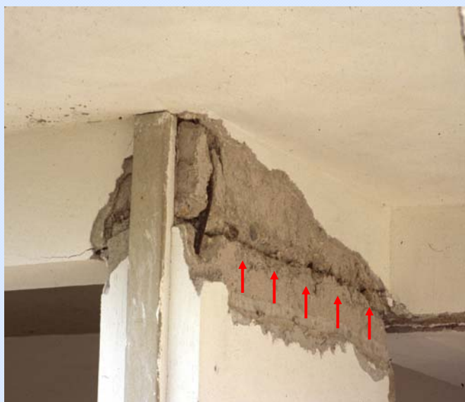
Ανεπαρκής αγκύρωση κάτω ράβδων δοκού λόγω σκυροδέτησης υποστρώματος πάνω από τη μασχάλη δοκού
