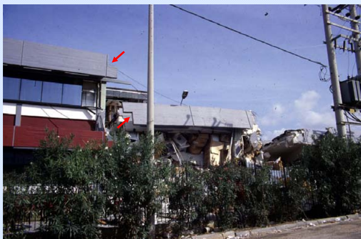
Στο ίδιο κτίριο, απώλεια στήριξης δοκού αρμού διαστολής λόγω μεγάλου ανοίγματος αρμού
