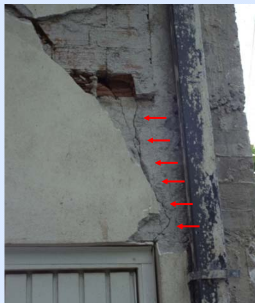
Ανεπαρκής αγκύρωση πάνω & κάτω ράβδων δοκού
