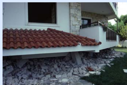
Τέδιο κτίριο, απώλεια ισογείου
