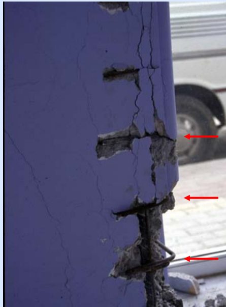
Εκτίναξη γωνίας διατομής σκυροδέματος λόγω μη συγκράτησης του κατακόρυφου οπλισμού στη γωνία συνδετήρα
