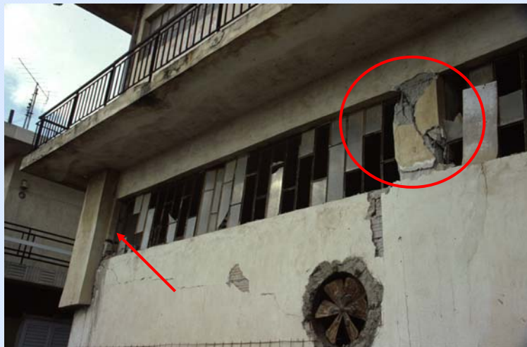
Αποτελεσματικότητα επισκευής με τοπικό μανδύα κοντού υποστυλώματος βλαμμένου από προηγούμενο σεισμό
