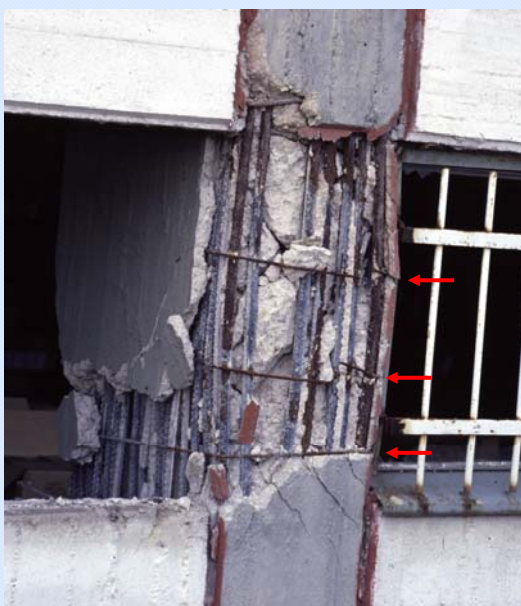
Αστοχία κοντού υποστυλώματος
