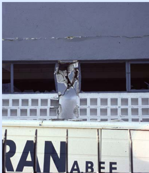
Αστοχία κοντού υποστυλώματος
