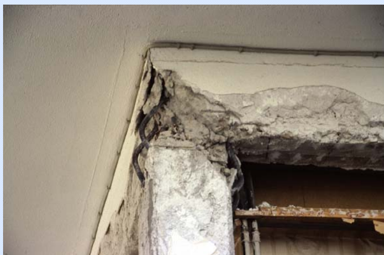
Αστοχία εξωτερικού κόμβου με μείωση ακαμψίας του
