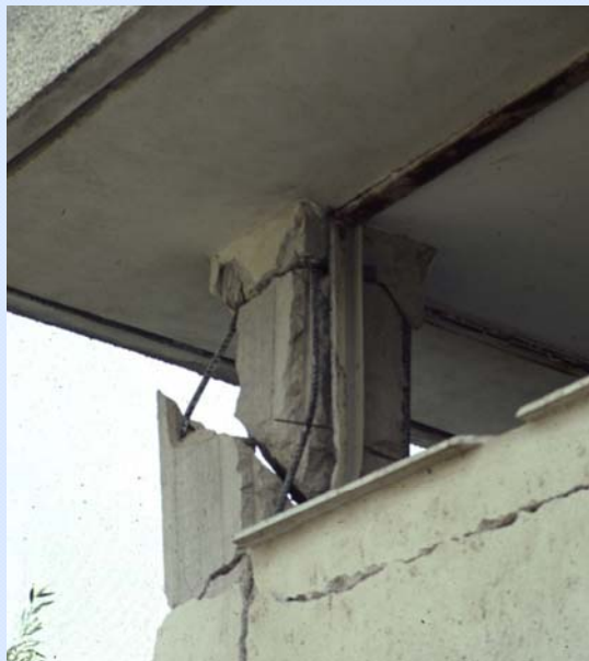
Αστοχία κοντού υποστυλώματος
