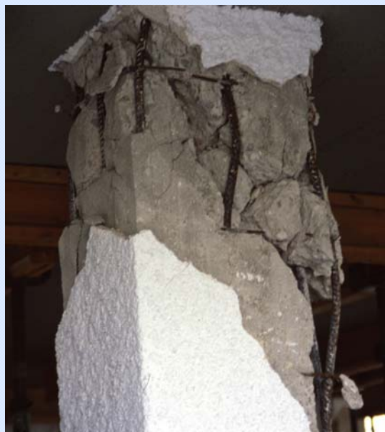
Διατμητική αστοχία υποστυλώματος με λυγισμό ράβδων & θραύση λεπτών & αραιών συνδετήρων
