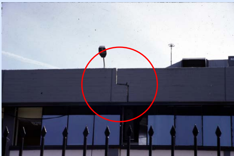
Μικρό άνοιγμα αρμού διαστολής από οριζόντια σεισμική μετακίνηση σε κτίριο μεγάλης κάτοψης
