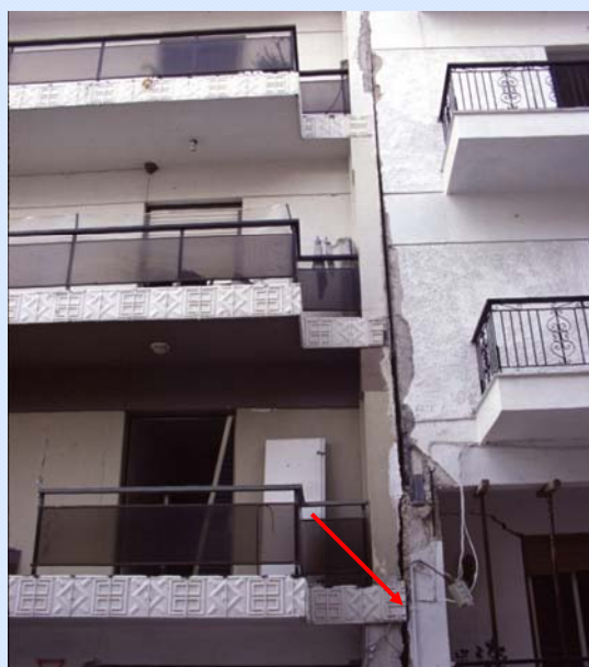
Εμβολισμός υποστυλώματος από την πλάκα γειτονικού κτιρίου
