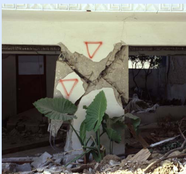
Διατμητική αστοχία τοιχώματος με μεγάλες παραμορφώσεις
