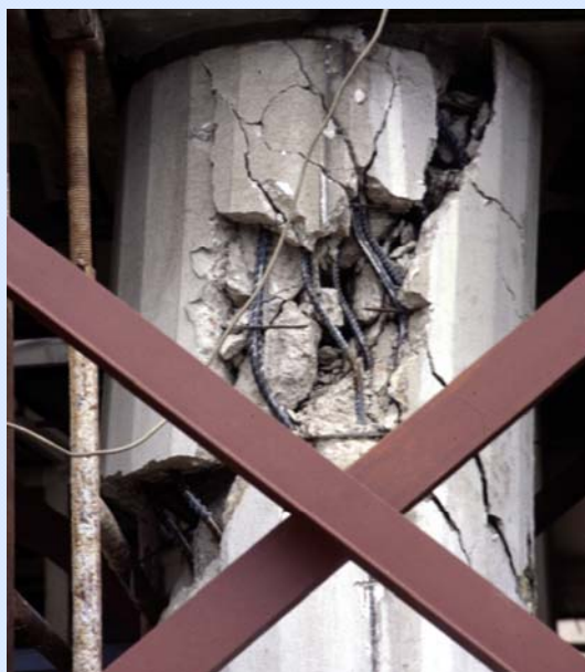
Διατμητική αστοχία υποστυλώματος με λυγισμό ράβδων & θραύση λεπτών & αραιών συνδετήρων
