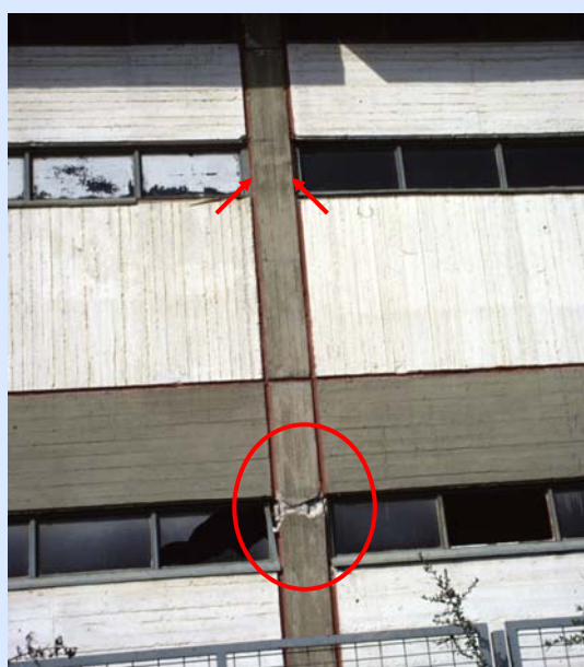
Αστοχία κοντού υποστυλώματος
