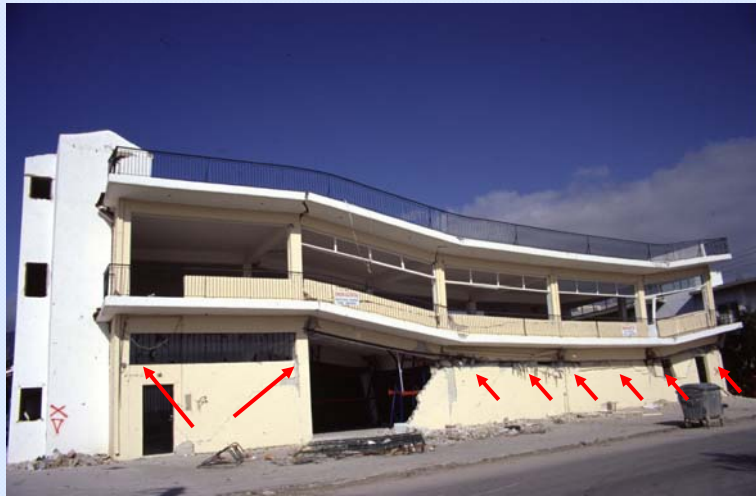
Αστοχία σειράς κοντών υποστυλωμάτων
