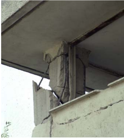
Φωτ. 15 (αρ.): Αστοχία κοντού υποστυλώματος
