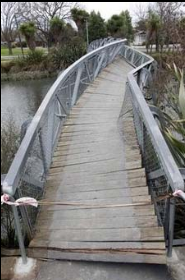
Κατεστραμμένη πεζογέφυρα πάνω από τον ποταμό Αβον στο Avonside, Christchurch
